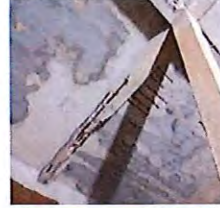
Aciers apparents corrodés - sous face de dalle
