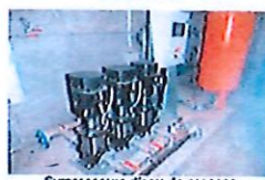
Compresseurs d'eau de process
